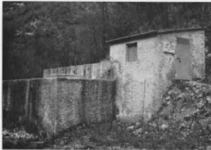
Acquedotto consor- ziale di Armentano. Serbatoio di carica con stazione di sol- levamento.
