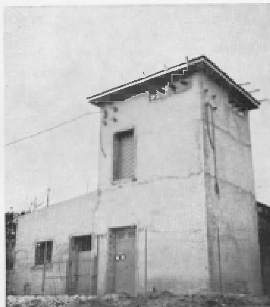
Acquedotto montano. Serbatolo. Sta- zione di pompaggio in località S. Anna.
