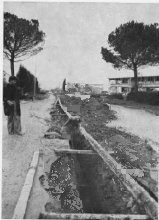
S. Maria degli Angeli, Via Los Angeles. Impianti di gas-metano.
