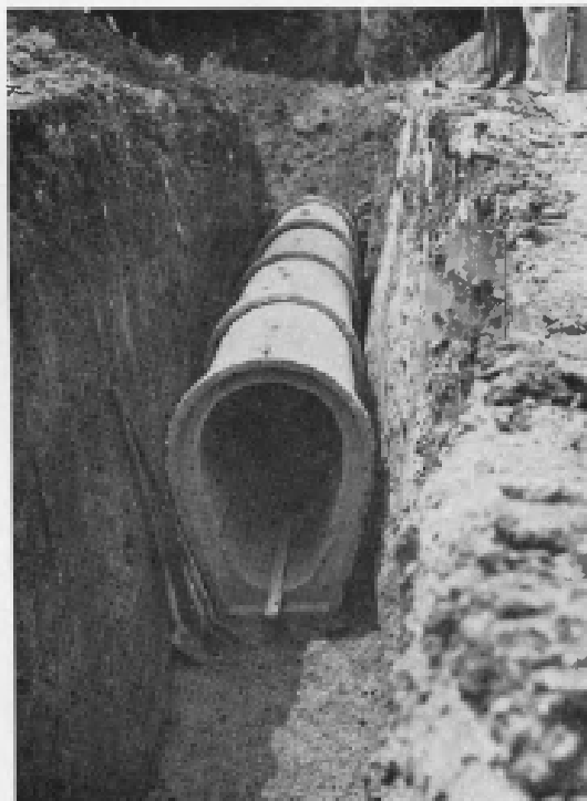
S. Maria degli Angeli. Opera di urbanizzazione P.P.E. settori 1/5-1/6. Costruzione collettori fognanti.
